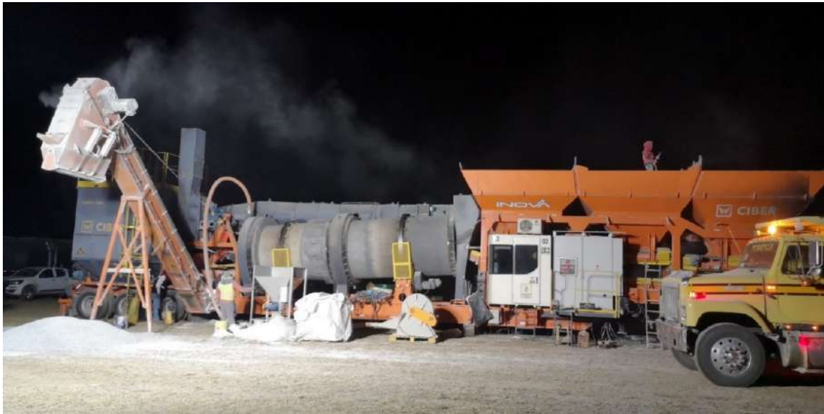
Figura 1. Planta de producción continua utilizada en el proyecto.
